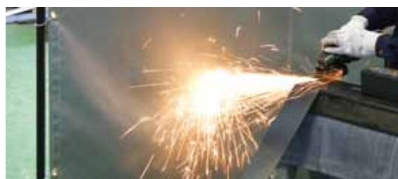
■火花衝立シート(防災・耐熱) 材質:コーテッドガラス AG-38
