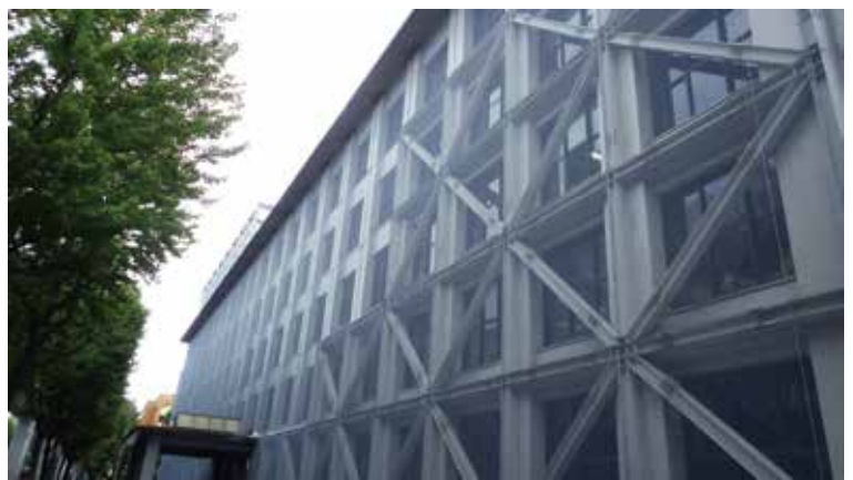
剥落防護ネット取付例
