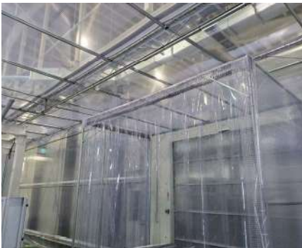
パイプブース
